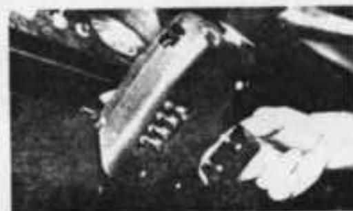
Fig. 49. Caja de fusibles.
