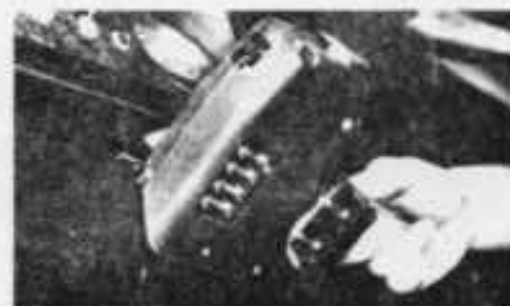
Fig. 84. Caja de fusibles.
